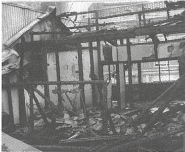
▲ 火災により焼けた建物
