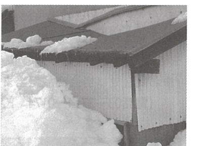
▲ 雪の重みでつぶれた屋根
