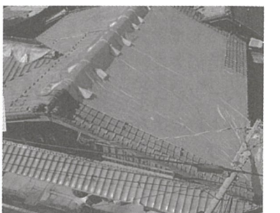
▲ 台風で飛ばされた屋根
