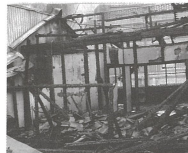
▲ 火災により焼けた建物
